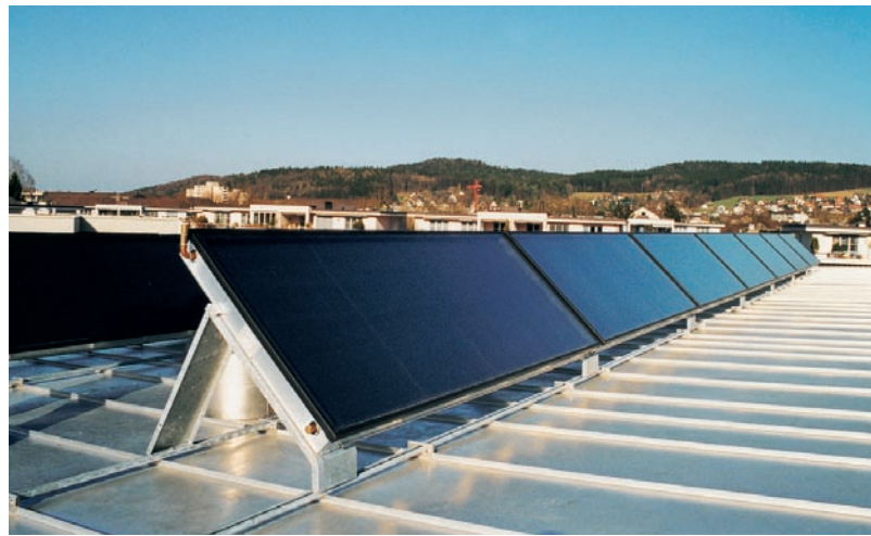
COBRA-Kollektoren für QUICKSOL im Mehrfamilienhaus.
